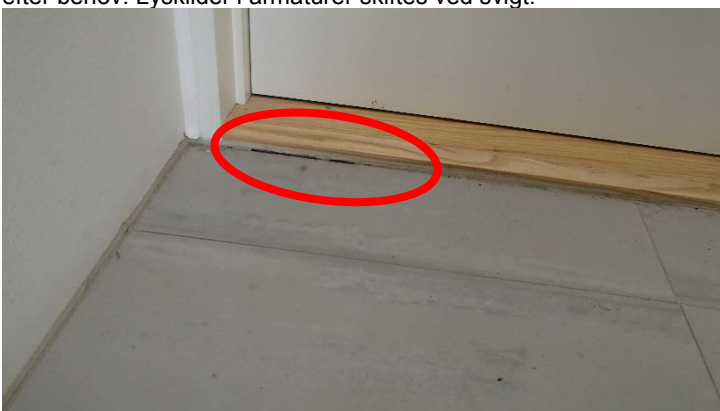
Fuger under entredøre til lejligheder kontrolleres for svigt (som på billedet). Fugen skiftes i tilfælde af svigt.
