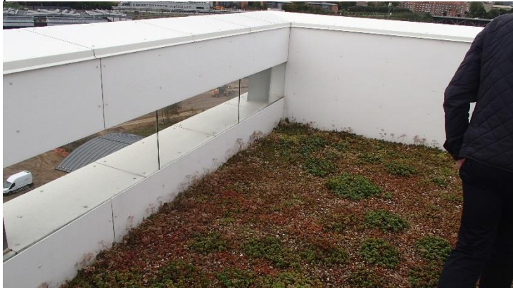
Sedum-tag langs murkrone på tagterrasser – der bør holdes afstand til eternit-beklædning.
