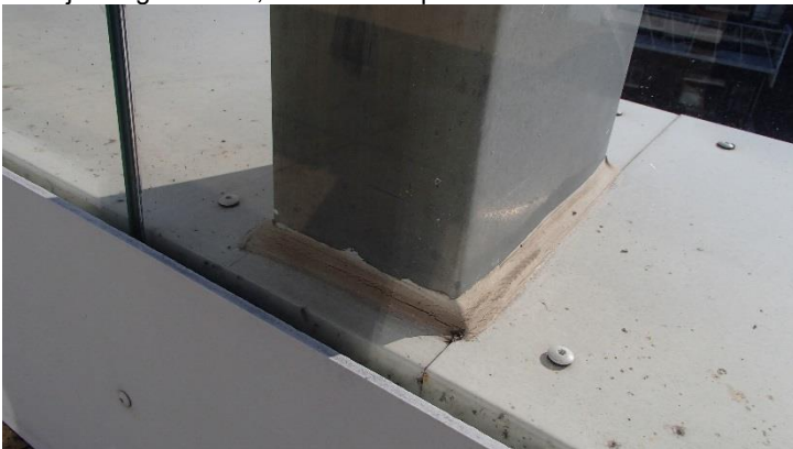
Svigtende fuger om bærende stålkonstruktion ved murkrone/værn på tagterrasser. Vandrette fuger er særligt udsatte.
