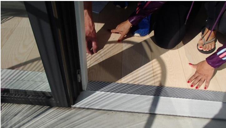
Fuger kontrolleres generelt jævnligt. Særligt vandrette fuger under terrassedøre og sideparti, da der her er øget risiko for svigt og dermed vandindtrængen.
