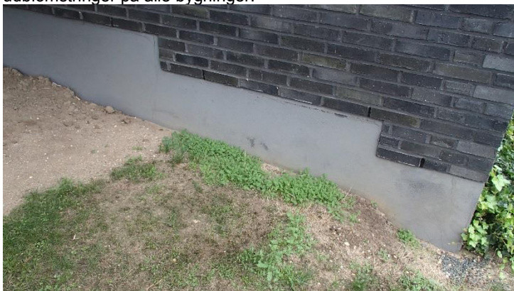
Sokkelpuds er flere steder revnet i overgangen mellem sokkel og murværk.
