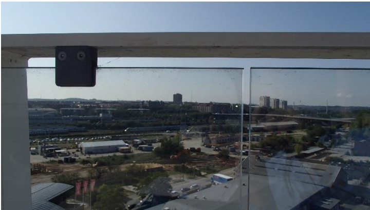
Holdere for glasværn kontrolleres for svigt i fastholdelsesevne – evt. efterspænding af disse.
