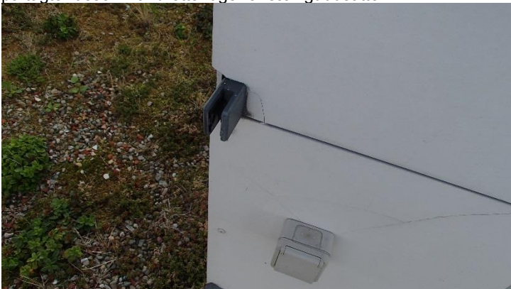
Beklædningsplader af eternit på tagterrasser. Bør kontrolleres og skiftes ved skade, som det ses på billedet, rundt om holder for glasværn, samt bag eludtag.
