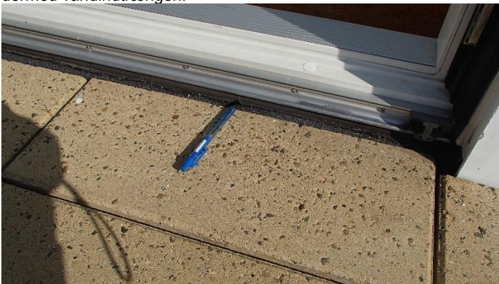
Fuge under døre på tagterrasser er forkert udført. En almindelig fuge mod bitumen kan ikke holde og slipper hurtigt (adhæsionsbrud).
