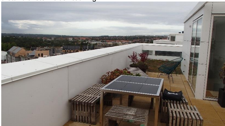
Tagterrasser med fliser. Særligt afløb fra underliggende tag-paptag skal jævnligt kontrolleres og renses for skidt.
