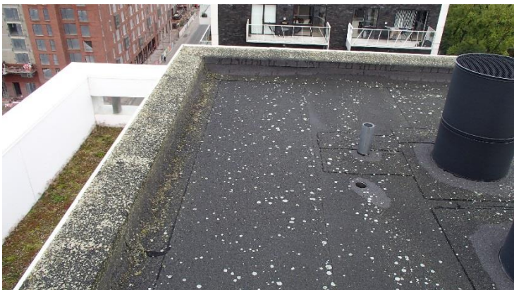
Der forekommer en del alge- og mosvækst på flade tage – særligt på murkronerne.
