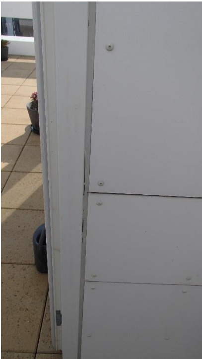
Fuger rundt om udvendige terrassedøre ved tagterrasser kontrolleres jævnligt for brud, som det ses på billedet.
