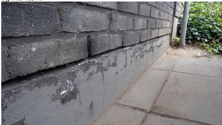
Afskallende sokkelmaling, revne i sokkel(puds) og salt-udblomstring forekommer flere steder.
