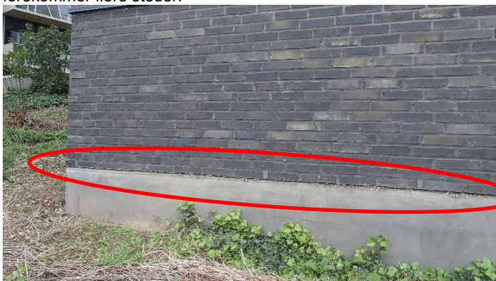
Billede viser indtørrede rester af efeu, der har fået fæste i overgangen mellem sokkel og murværk. Efeu bør fjernes fra facader.
