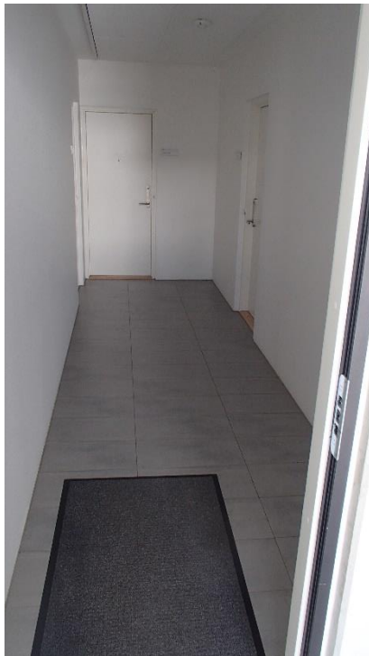
Fordelingsgang: Gulve fejes og vaskes efter behov. Vægge males efter behov. Lyskilder i armaturer skiftes ved svigt.
